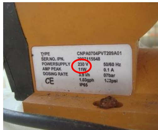
ป้ายบอกรายละเอียดเครื่องสูบน้ำจ่ายคลอรีน
