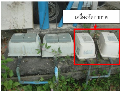
เครื่องอัดอากาศ (Air compressor)
