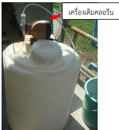
ระบบเติมคลอรีน
