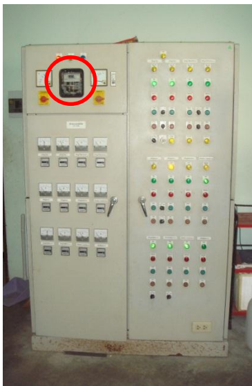
ตู้ควบคุมระบบฯ
