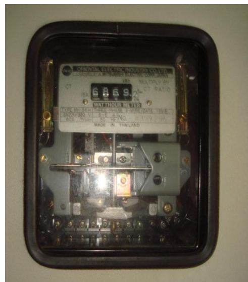
มิเตอร์ไฟฟ้า
