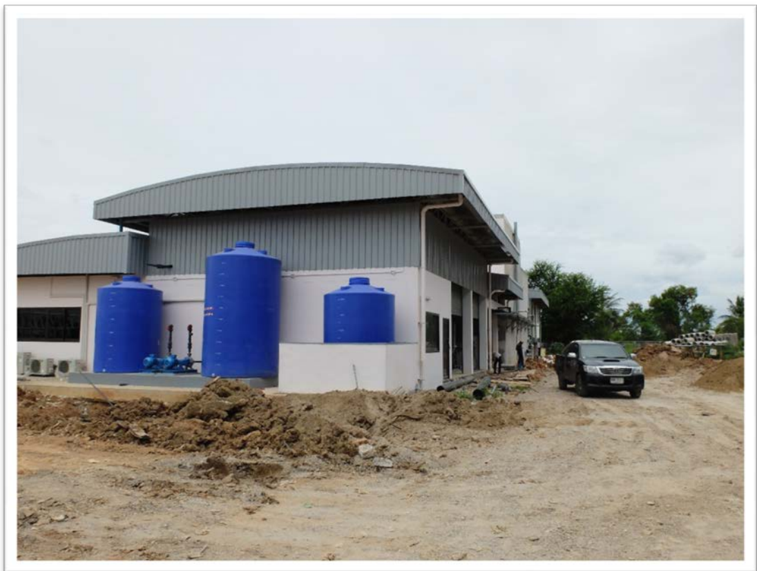
ภาพที่ 5 อาคารบำบัดน้ำเสียแบบ MBR และ RO
