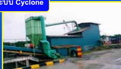
ระบบ Cyclone
